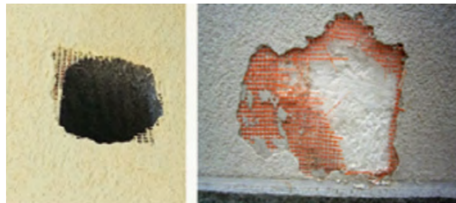
Esempi di errato incollaggio della rete
