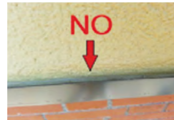
Errata sigillatura della fuga tra cappotto e profilo di chiusura
