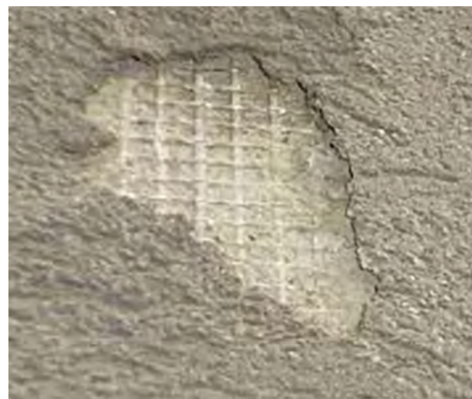
Distacco superficiale del rivestimento di finitura
