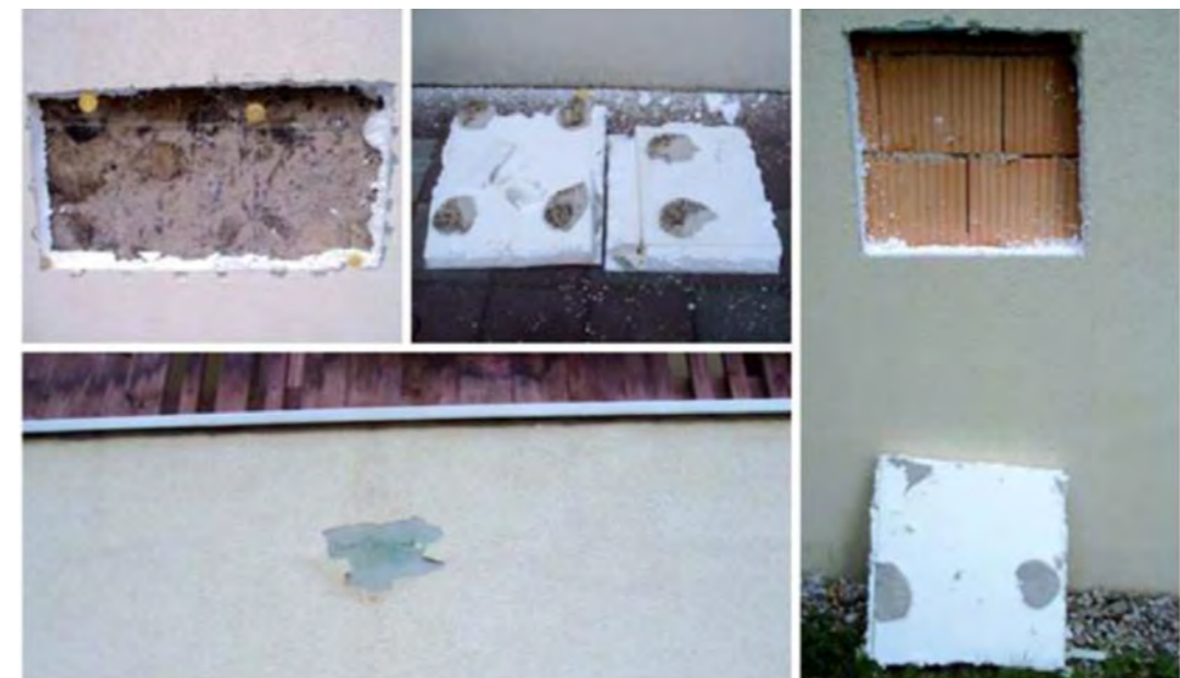
Prove di valutazione cappotti esistenti con esito negativo - non attuabile il raddoppio
